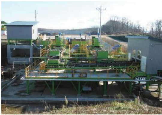
新設された受け入れ設備
