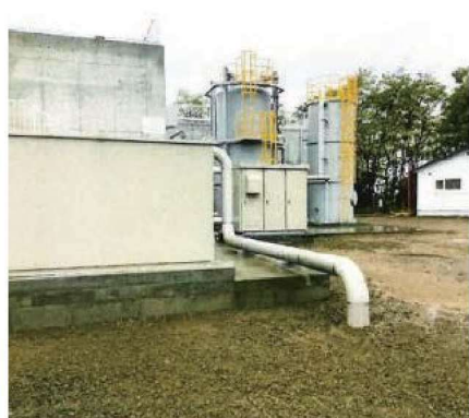
嫌気処理設備
