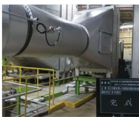
増強された乾燥設備
